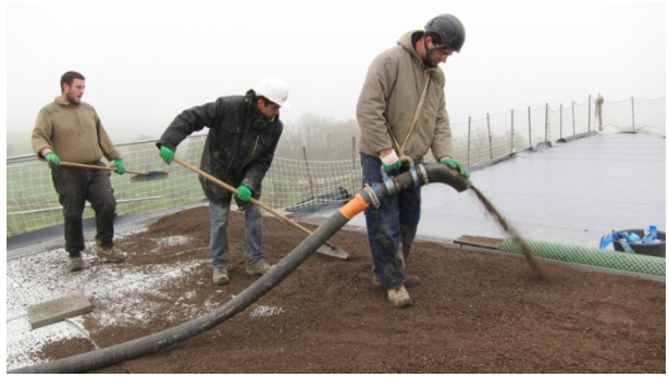
Figure 9.8 Mise en œuvre de la couche de substrat par soufflage, puis nivellement – pente comprise entre 21 et 35 %
