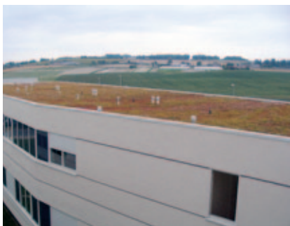
HYDROPACK® (Châtelleraut, septembre)
